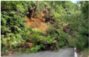
林道の法面崩壊（八代市）
