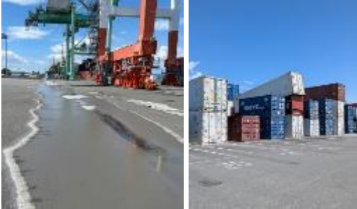
八代港の被害状況
