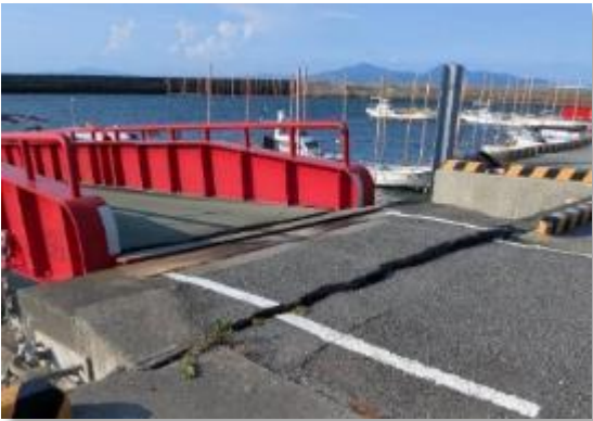
浮桟橋接続部の亀裂 (宇土市)
