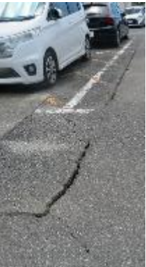
宇城警察署 駐車場の亀裂
