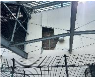
医療施設 被災状況
