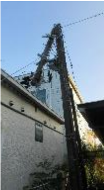
宇城警察署 電線引込柱の折損
