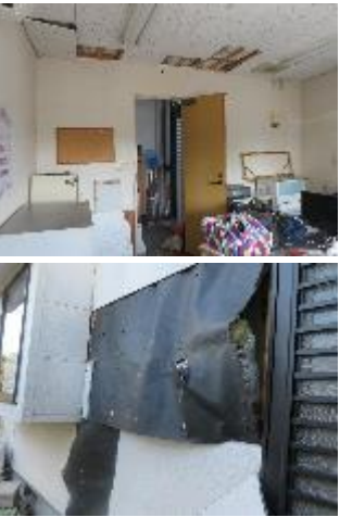
宇城警察署豊野駐在所 の被害状況
