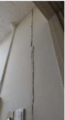
御船警察署 庁舎内の亀裂
