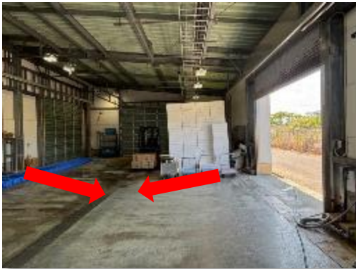
八代共同魚市場の地盤の傾き (八代市)
