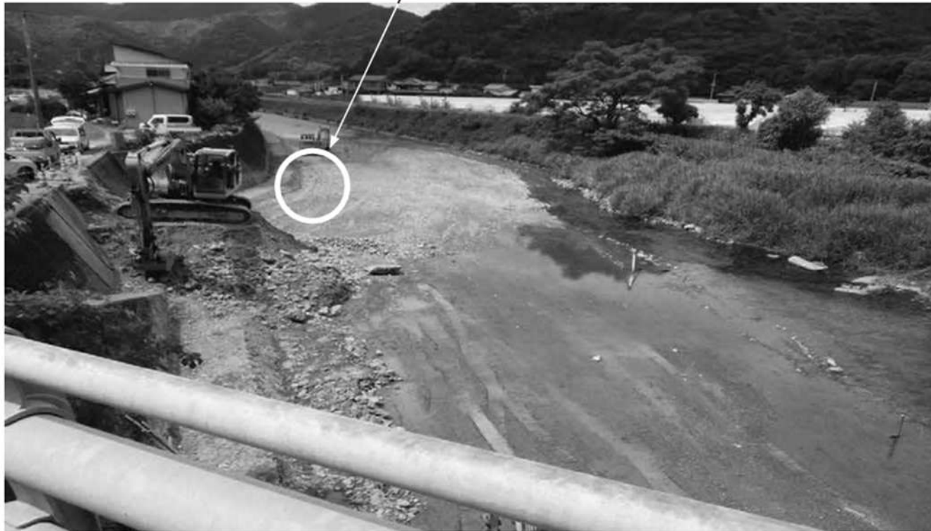
災害発生現場
