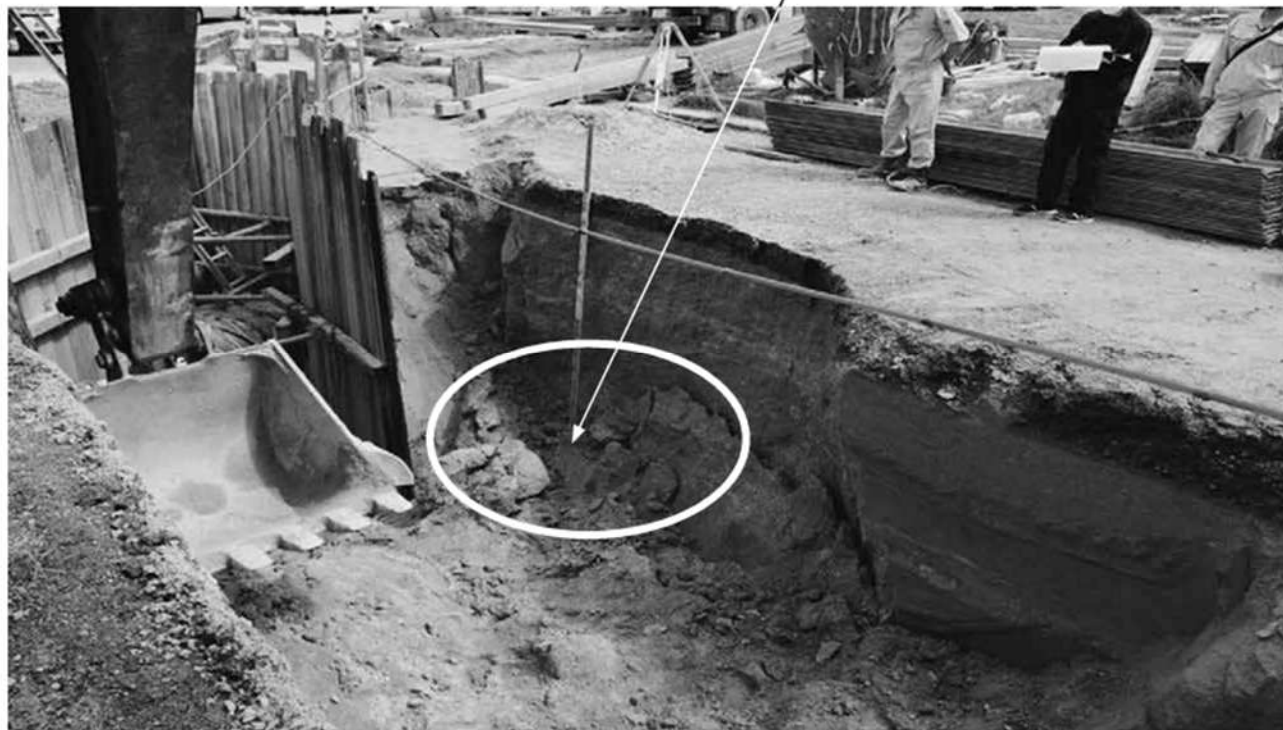
崩壊した土砂
