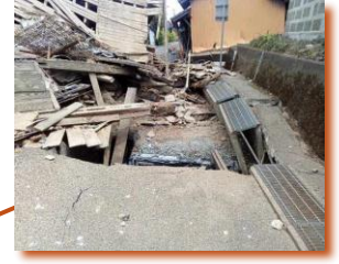
↑幹線用水路の沈下 （氷川町）
