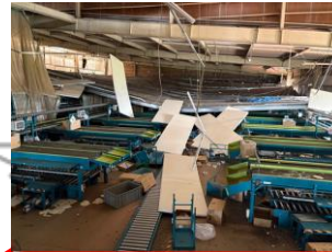
J A 熊本経済連 第二園芸集送センターの損壊→ （宇城市）
