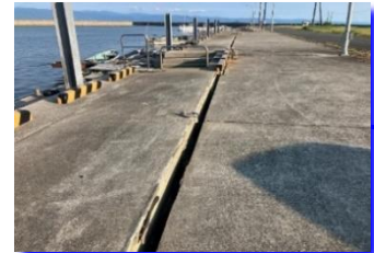
↑物揚場の傾倒・沈下 （郡浦漁港（宇城市））
