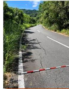
←不知火中腹 基幹農道の亀裂 （宇城市）
