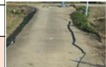
コンクリート舗装の割れ
