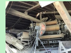
▲いぐさ製織作業場の倒壊 （八代市）
