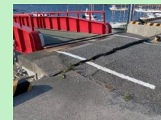
▲浮棧橋の損傷 （宇土市）
