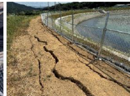
ため池堤体のクラック
