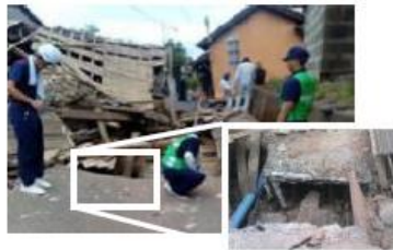
幹線水路の被災状況
