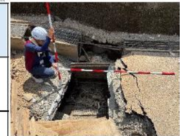
ボックスカルバートの破断
