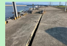
▲物揚場の傾倒・沈下 （宇城市）
