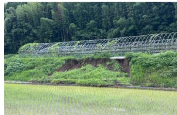
⑫ 農地の法面崩壊（熊本市）
