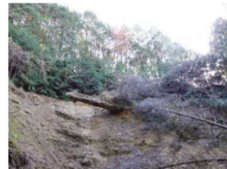
⑬ 林道の路体崩壊（水上村）
