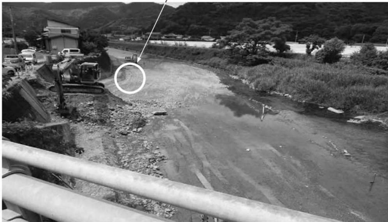
災害発生現場
