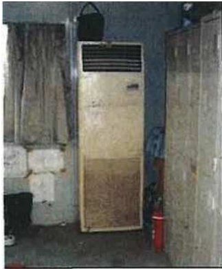
写真 3 : 休憩所に設置したエアコン
