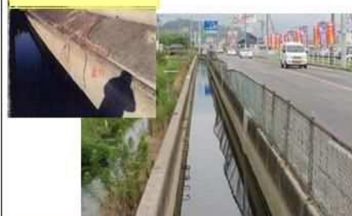
水路側壁のひび割れ
