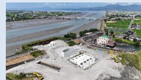
【農地】竜北排水機場(八代郡水川町)
