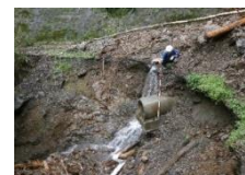
⑩保安林管理道の崩壊(八代市)
