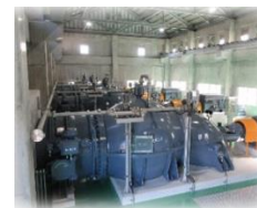
農業水利施設（排水機場）
