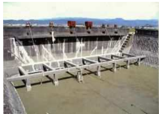
樋門の土砂堆積(豊川海岸)
