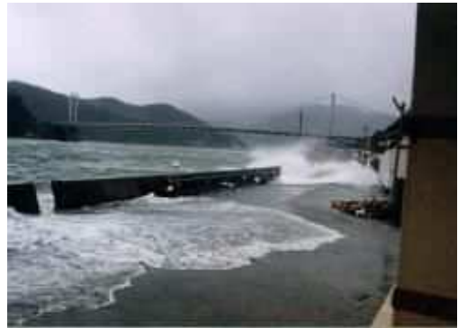
越波による被害(上天草市龍ヶ岳町)
