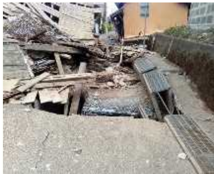
幹線用水路の沈下 【氷川町】
