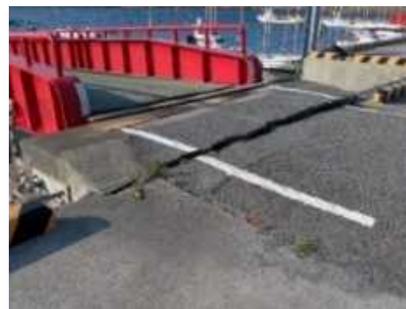
浮棧橋の損傷 【宇土市(赤瀬漁港)】
