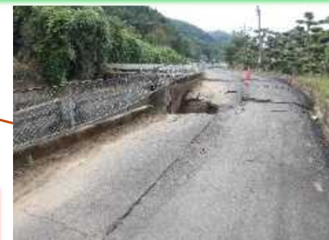
幹線用水路の崩壊 【八代市】
