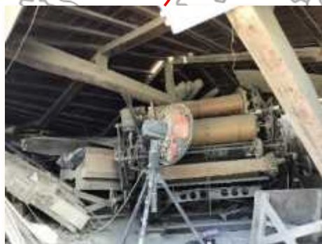
いぐさ製織作業場の倒壊 【八代市】
