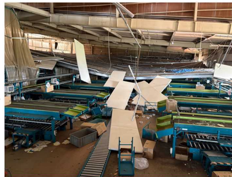
集出荷施設の損壊 【宇城市】
