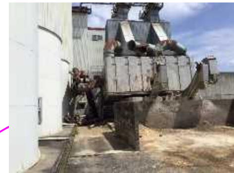
カントリーエレベーターの損壊 【氷川町】
