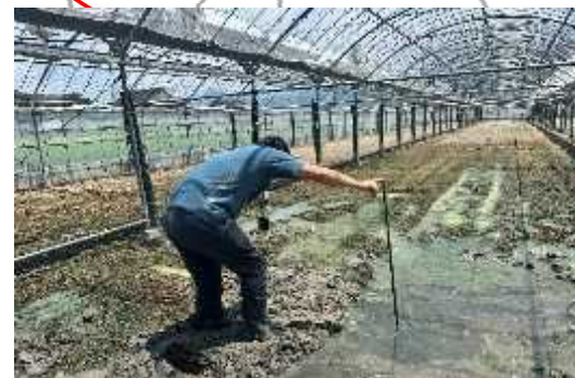
ハウス内部の液状化 【八代市】
