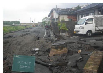
地震で被災した下水管渠 (益城町)
