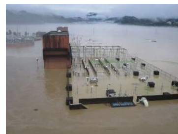
浸水した下水処理場 (人吉市)
