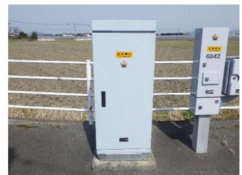
令和6年度（2024年度）設置 信号機電源付加装置
