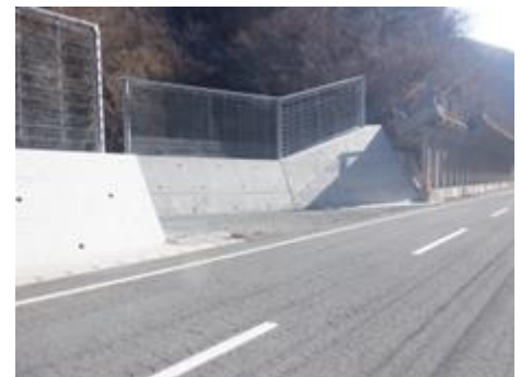
道路防災事業：国道445号（八代市）
