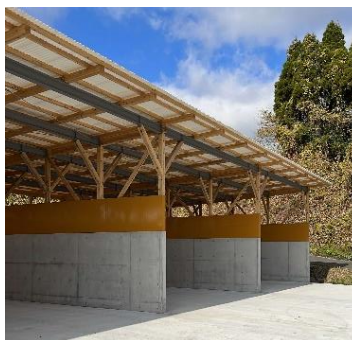
家畜排せつ物堆肥化施設
