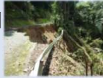
道路崩壊 (甲佐町)
