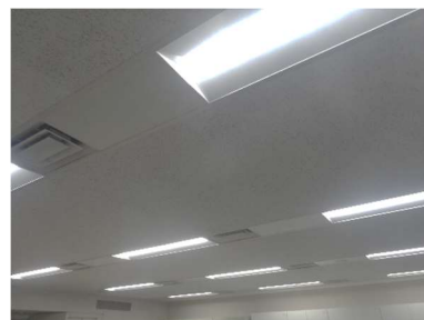
LED照明を導入した施設
