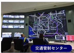
交通管制センター
