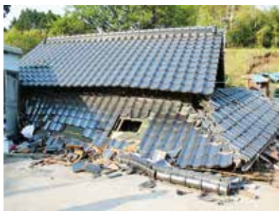
全壊した家屋（西原村大切畑地区）
