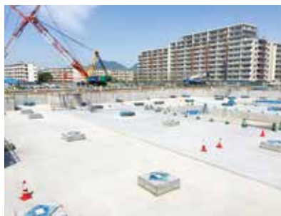
震災直後の工事現場状況（高野病院）
