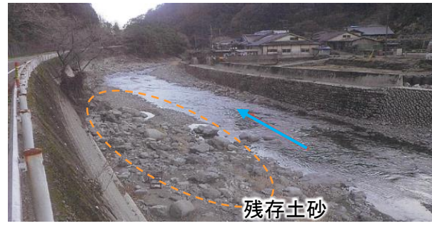
写真3 残存土砂の堆積状況 (R2.11月)
