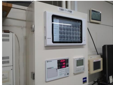
各部屋の空調をデマンドで管理
