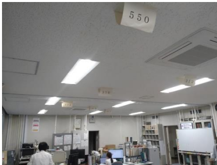
執務室のLED化の様子
