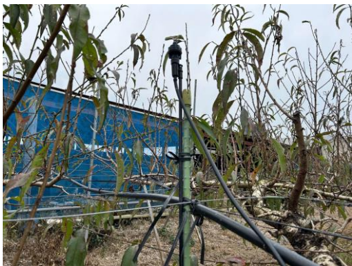
図2 スプリンクラーの設置状況
