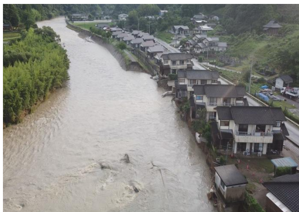
【護岸流失】万江城内地区
