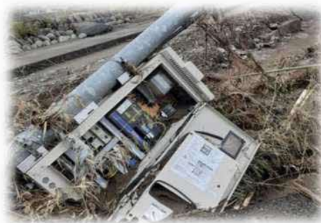
農業集落排水施設
